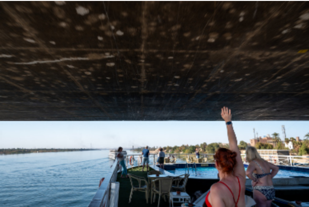
Brückenberührung von unten
